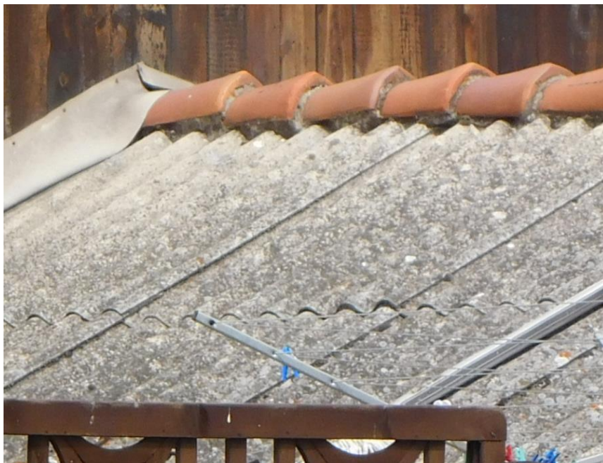
Fot. 1 Płyta azbestowa falista stosowana w budownictwie.
